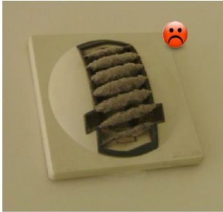
Illustration 70: Bouche d'extraction encrassée
